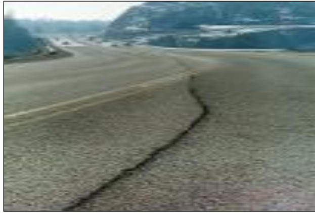
Şekil 5.6. Yüksek önemde boyuna çatlak
