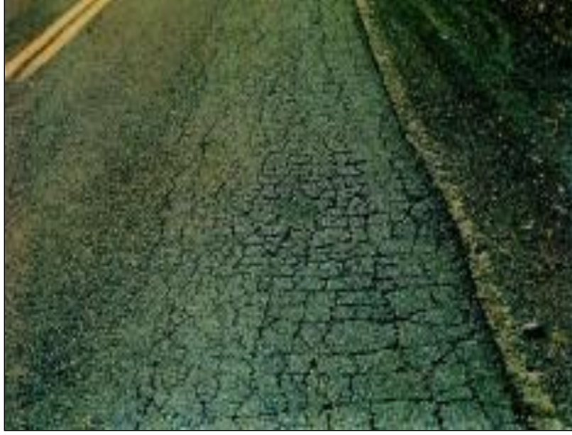
Şekil 5.2. Timsah sırtı çatlak
