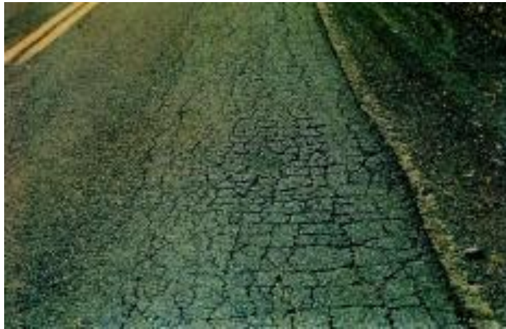
Şekil 2.26. Timsah sırtı çatlak
