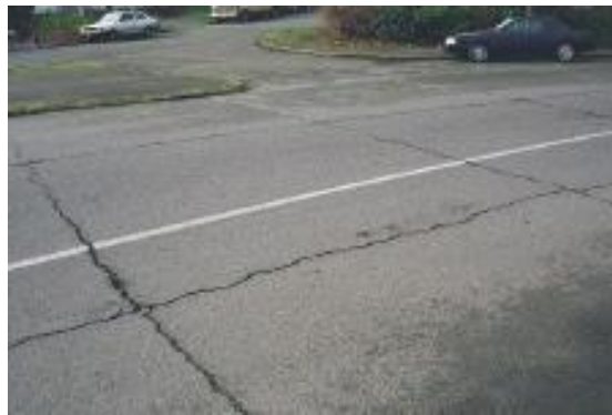
Şekil 2.31. Yüksek önemde yansıma çatlağı
