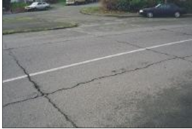
Şekil 5.7. Yüksek önemde yansıma çatlaęı
