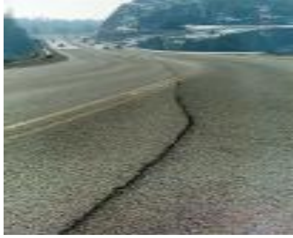
Şekil 2.30. Yüksek önemde boyuna çatlak
